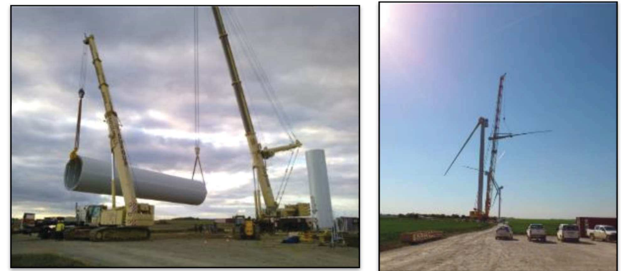
Figure 12 : Montage des éléments du mat (à gauche) et de l'hélice « pale par pale » (à droite)
